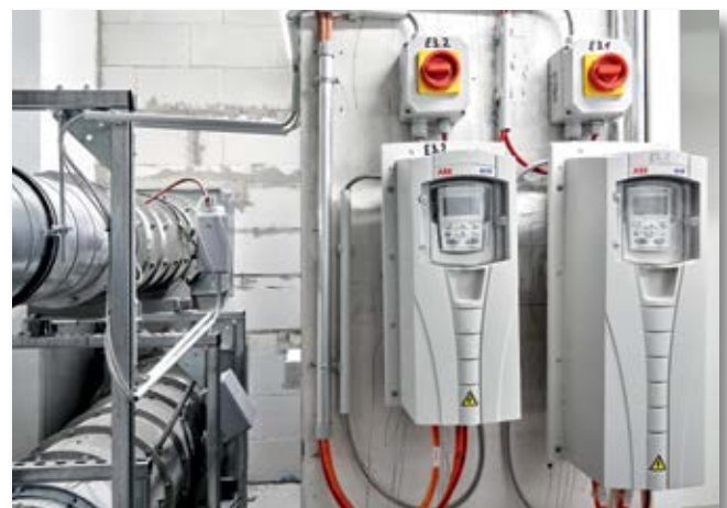
Frequenzumrichter ermöglichen eine Drehzahlanpassung der Entrauchungsventilatoren.
