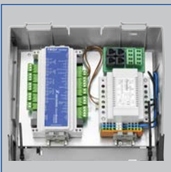
Installationsgehäuse mit bauseitiger Ergänzung Zonenmodul und Splitter
